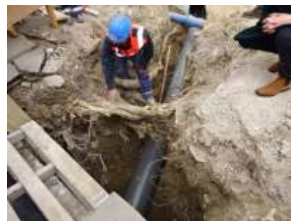
Photo : pr sence du syst me racinaire d'un arbre lors d'une intervention sur r seaux enterr s - cr dit Corinne Bourgery
