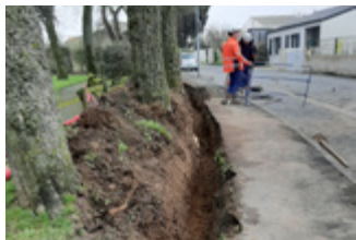
La Rochelle a employé le Barème VIE/BED pour évaluer les dégâts d'une tranchée de réseaux au pied d'un alignement public. I © André Guyot, La Rochelle
